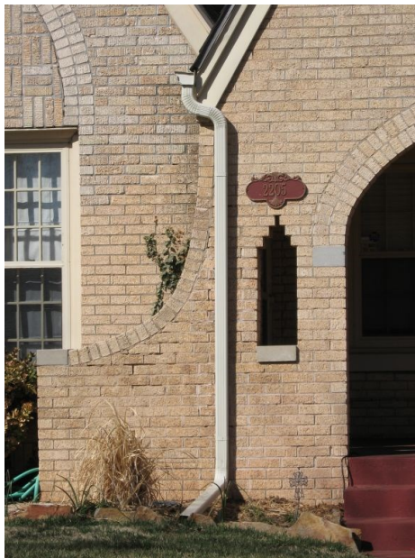
Las canaletas se deben ubicar y diseñar de manera que canalicen el agua lejos del edificio (2205 NW 26th Street).
